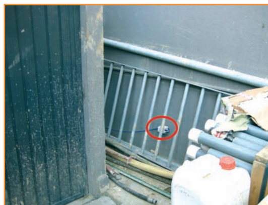
[Figura 9] .- Captador triaxial ubicado en la cimentación del edificio (40 cm sobre ella).
